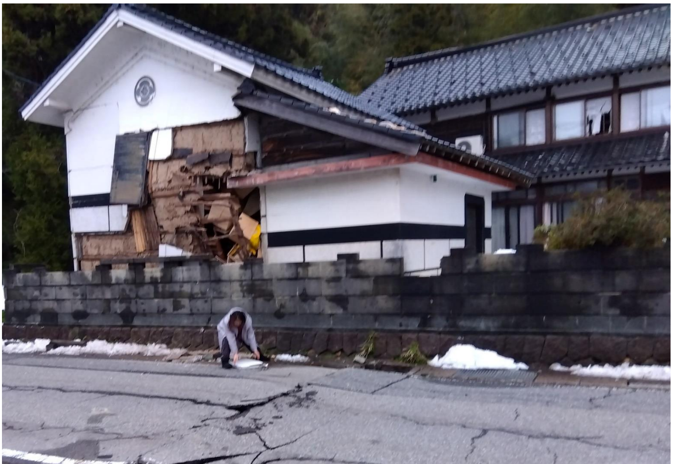
蔵が壊れる。2階の床が脱けた
