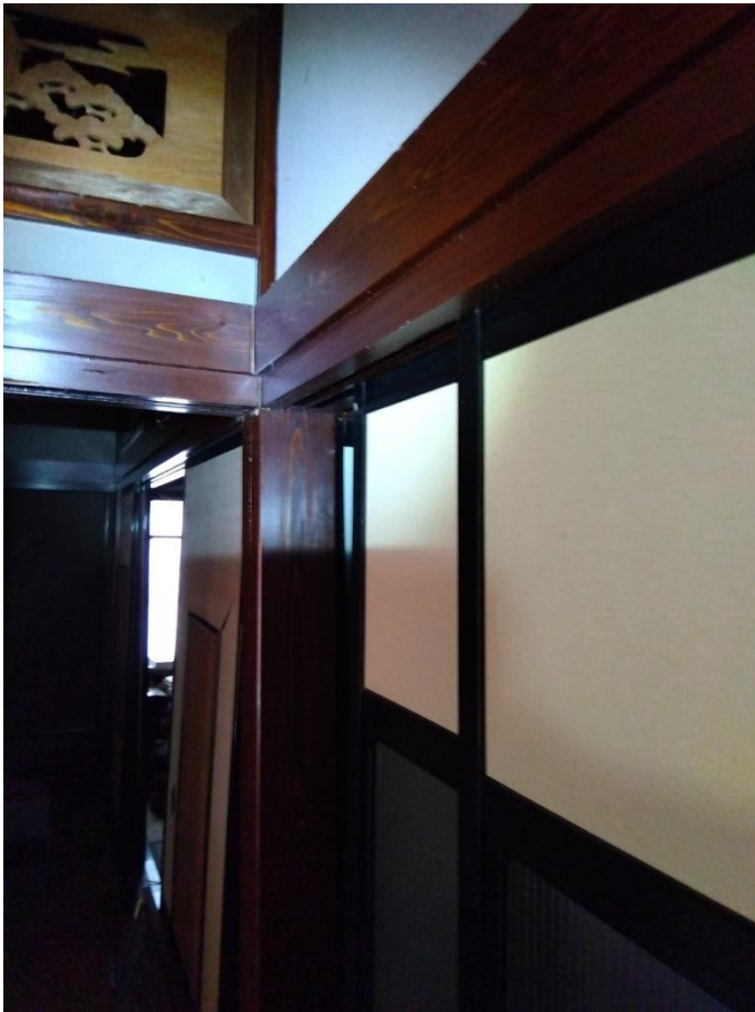
母屋の中の柱が中央で折れて傾く
