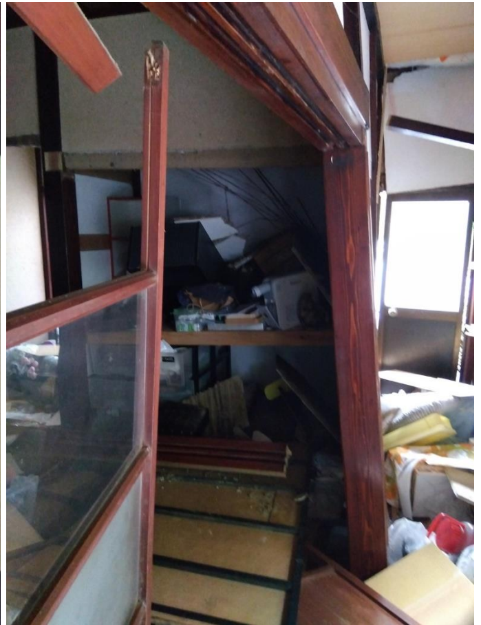
母屋：柱の下が押し出され柱が傾く 押し入れの鴨居が落ちている
