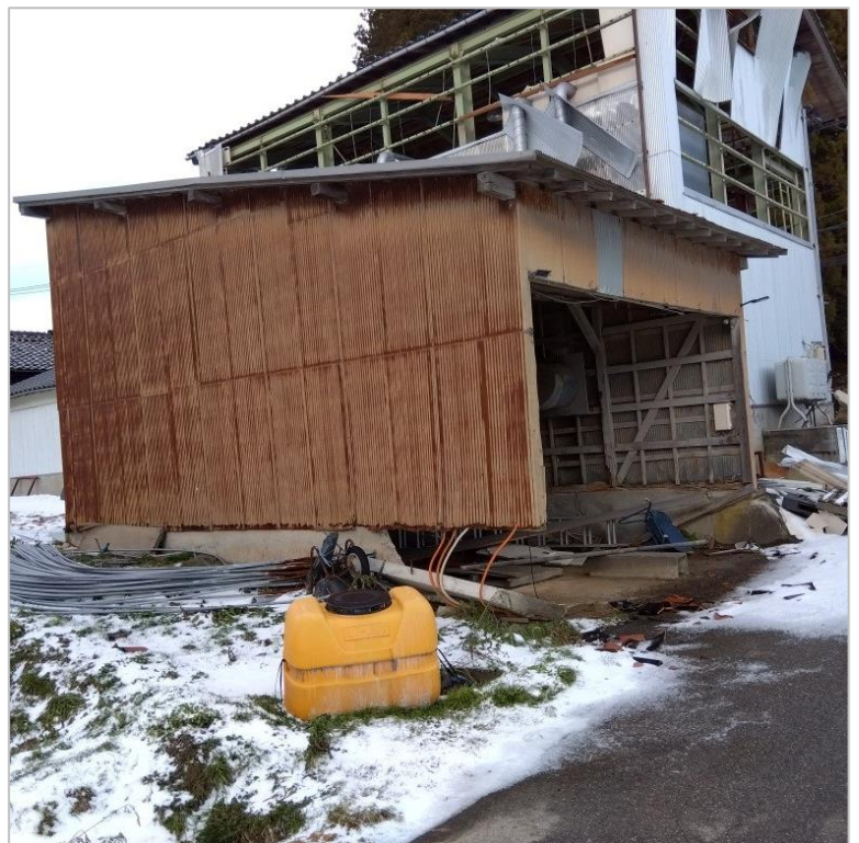
① 物置が壊れた(手前)。土台・柱・壁。 ② 奥の方の作業所が壊れた。屋根がずれる。 壁が外れる。
